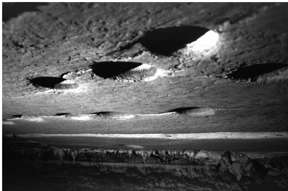
Fig. 2 - Erosione del soffitto
